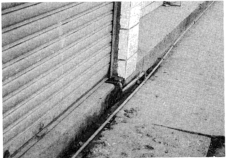
図8 市内で家庭に入る給水管
